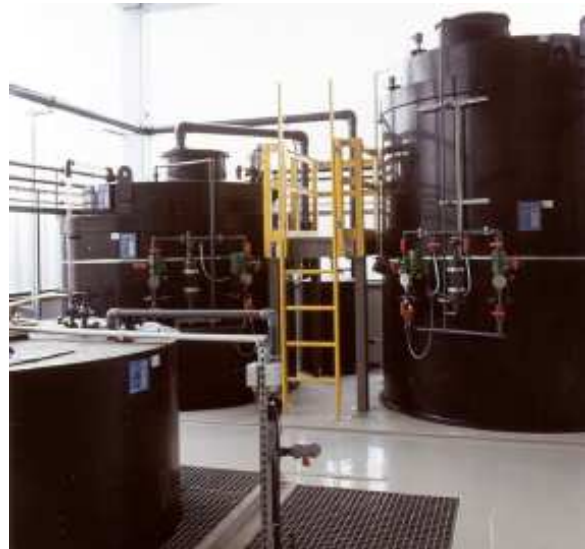
Неутрализация и съхранение на химикали / neutralization and storage tanks for chemicals
