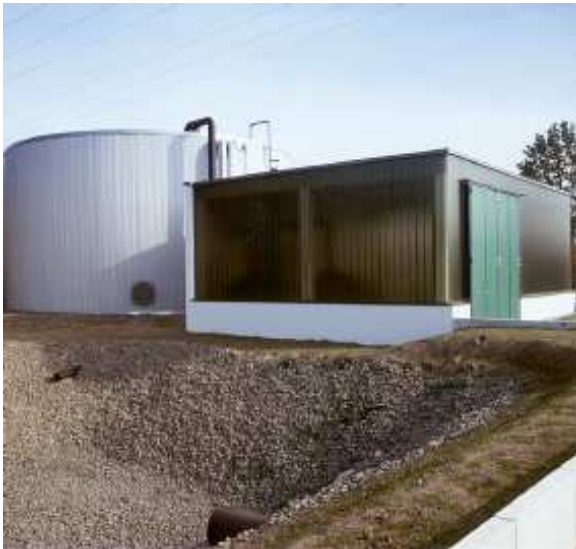
Смесително-изравнителен резервоар / Tank for mixing and equalization
